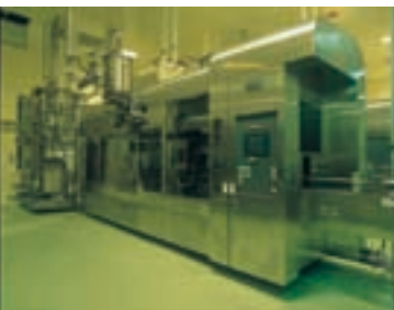
ESL 使用充填機 (ケーブルパック)
